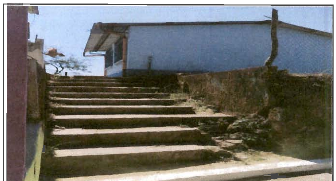
Foto 10: remozamiento de gradas en mal estado
